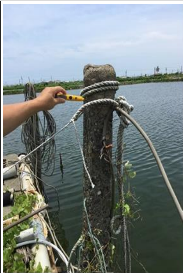
電源線絕緣劣化且被細鐵絲纏繞凹陷，彎折處漏電測試警示燈亮示意圖。
