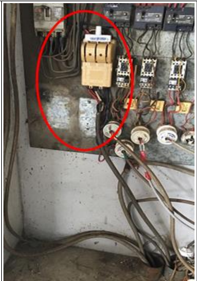
工寮內設置配電盤剝刀開關控制線路，未設漏電斷路器。
