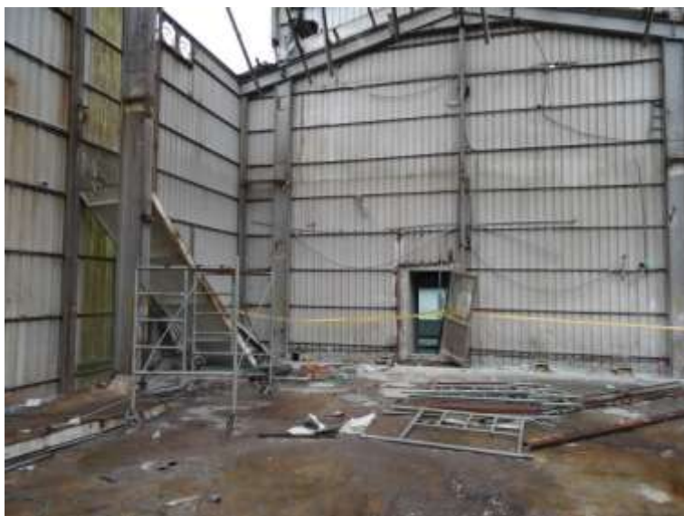
事發後移動式施工架(地面之物件於事發急救時已移動)
