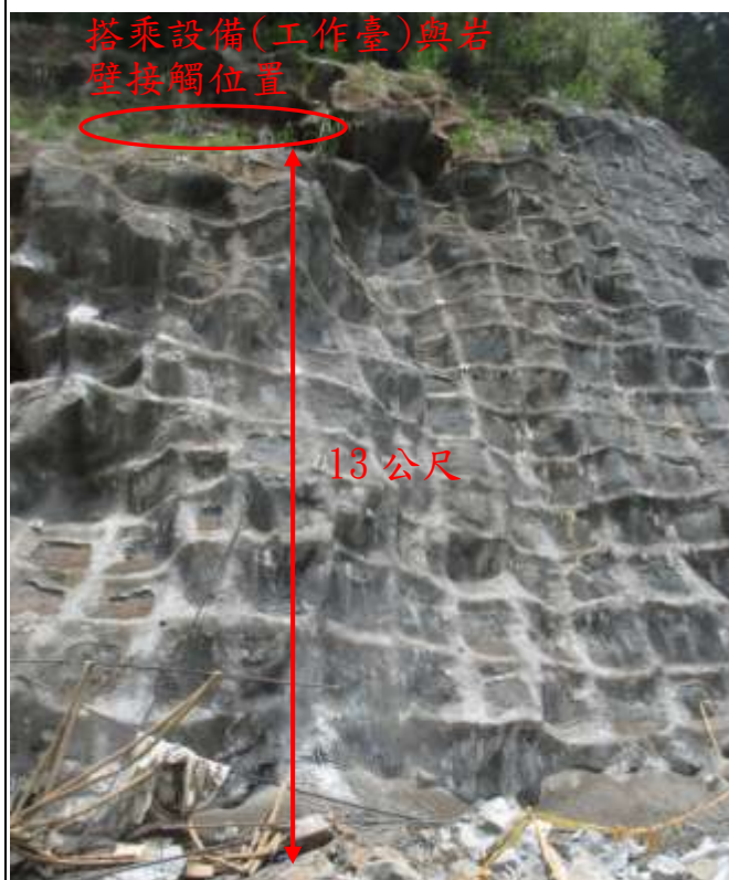
說明二 照片2 墜落高度約13公尺。搭乘設備(工作臺)與岩壁接觸位置，如紅圈處所示。
