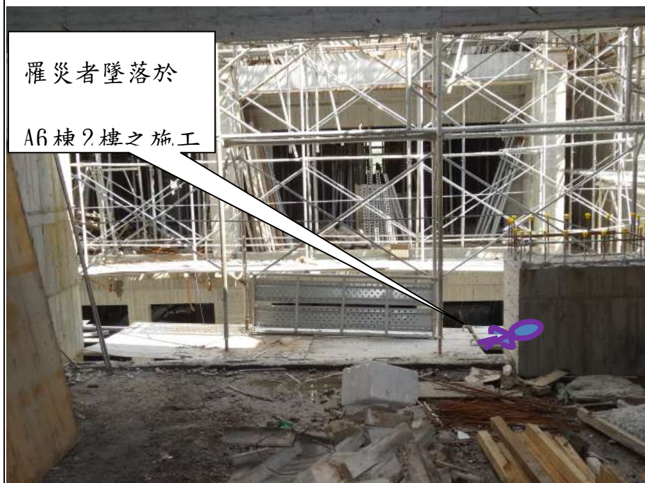
說明 照片二：罹災者倒臥在 A6 之 2 樓外牆施工架底版處。
