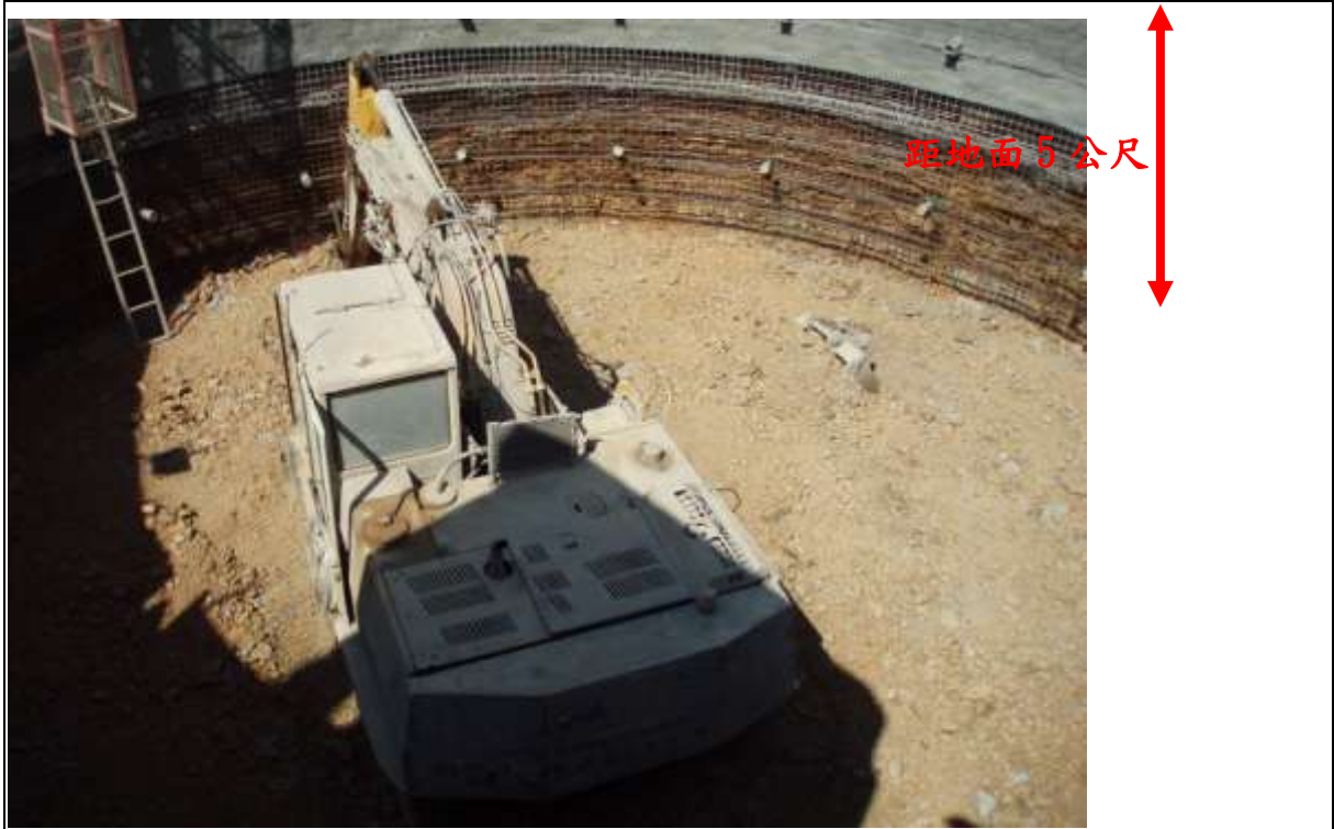
說明三 照片三：P56 橋墩基礎之井基直徑為 20 公尺，災害檢查當日已開挖深度約 5 公尺（設計開挖深度為 20 公尺）。
