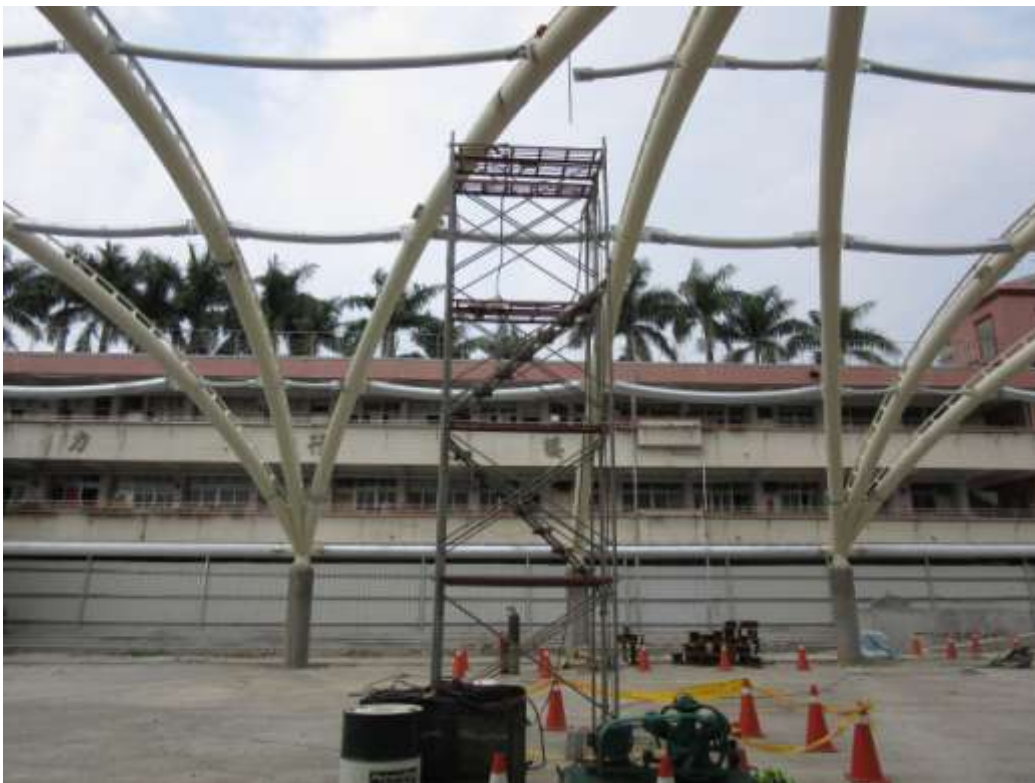
說明：移動式施工架第 1 層及第 4 層未設置上下設備及頂端開口未設置護欄
