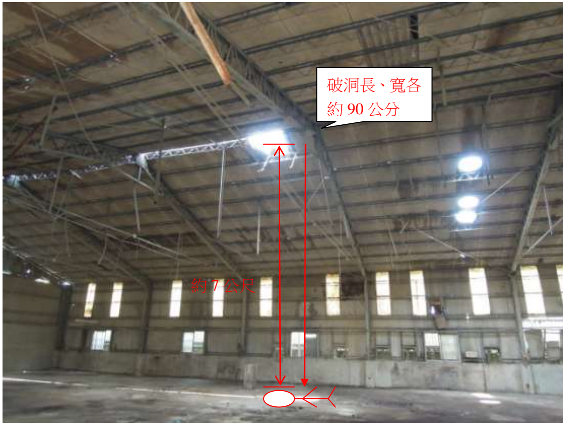
說明 2 罹災者踏穿高約 7 公尺石綿板屋頂墜落至地面
