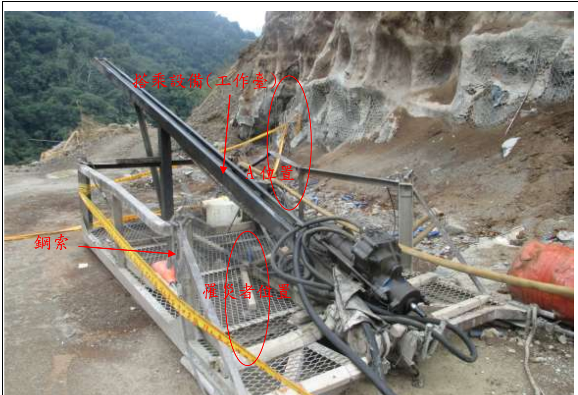
說明一 照片1 罹災者搭乘該搭乘設備(工作臺)長4.55公尺、寬2.2公尺、高1公尺。
