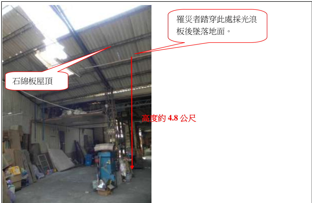
附照 災害現場位於倉庫屋頂換修工程之 1 樓屋頂。
