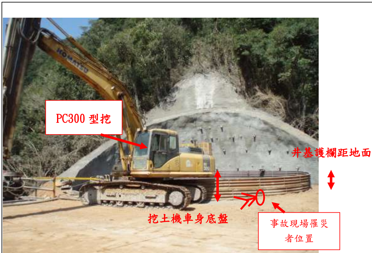
說明一 照片一：災害發生於「台東縣○○鄉之○○新建工程」之編號○○橋墩基礎之井基處（本署於事故現場檢查當時，現場已淨空）。
